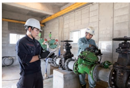
南城市農業用水管路水圧制御施設
