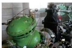
農業用減圧弁ユニット
