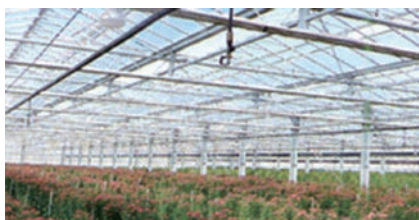
頭上散水設備
