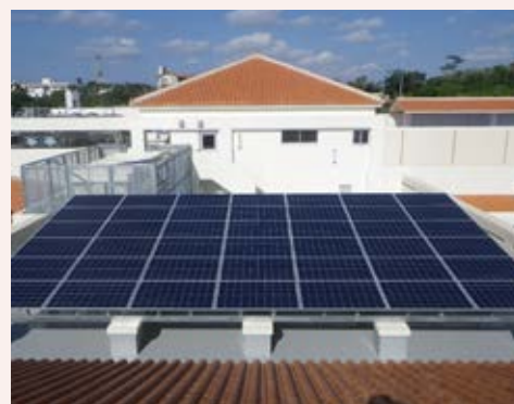
太陽光発電設備
