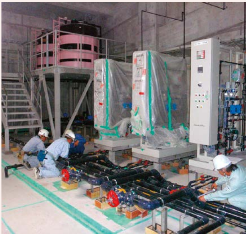
薬品注入機械設備
