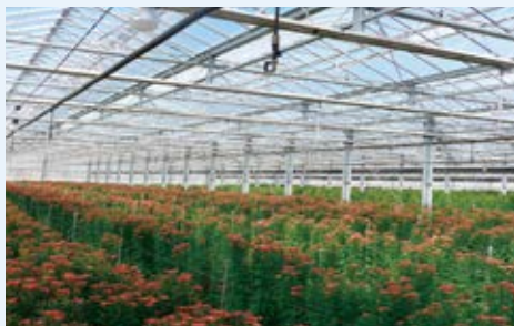
頭上散水設備
