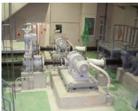
ポンプ機械設備
