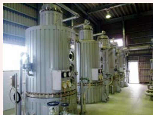
製糖工場設備(濃縮設備)
