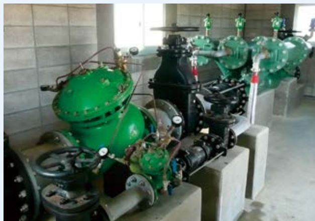
農業用減圧弁ユニット
