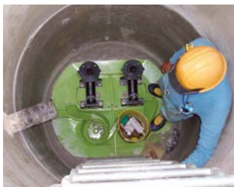
下水用マンホールポンプ
