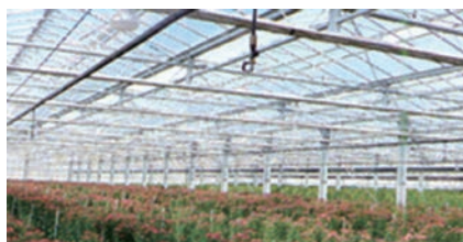
頭上散水設備
