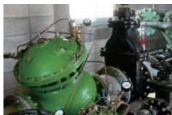
農業用減圧弁ユニット
