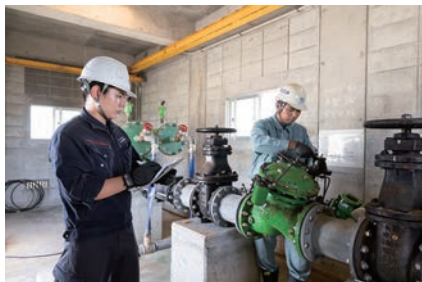
南城市農業用水管路水圧制御施設
