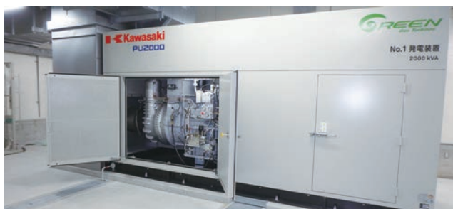
沖縄クラウドデータセンター（発電機）
